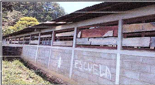
FOTO 1: COLOCADA DE BALCONES
